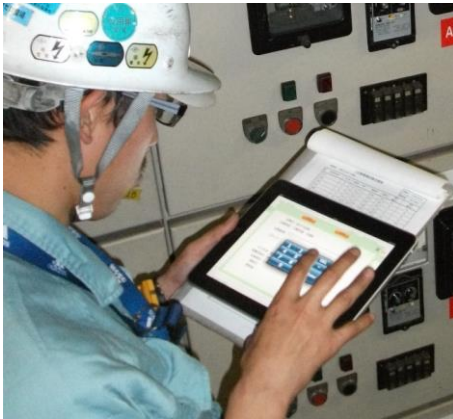
継電遮断機点検での利用例
